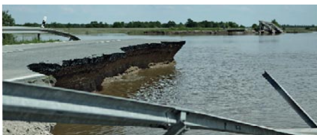
Seite 30 Bei Löbnitz bricht der Damm der Mulde
